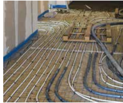
Adullam-Neubau: Die Photovoltaik- anlage auf dem Dach produziert Strom und die Rohre für die Bodenheizung werden verlegt.
