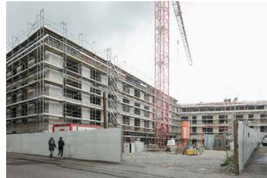
Der Rohbau des Geriatriezentrums der Adullam Stiftung zeigt den Gebäudeteil mit den 67 Pflegeplätzen, der bis im Herbst 2015 abgeschlossen werden soll. Erst dann wird der Spitaltrakt mit 51 Betten entlang der Schützengasse erstellt.
