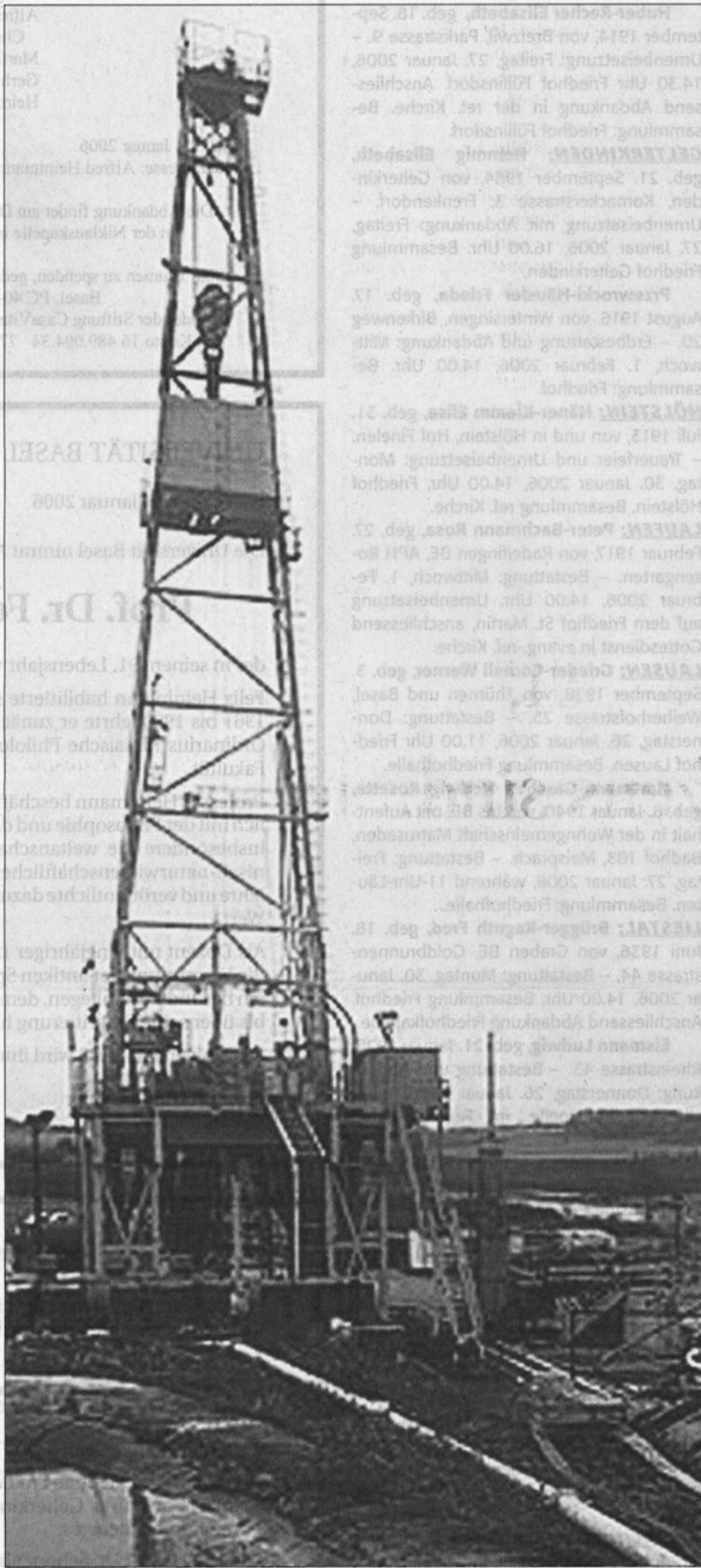
START. Schon im Mai soll in 5000 Meter Tiefe im Hinblick auf die künftige Geothermieanlage in Kleinhüningen – im Bild ein ähnliche Heizkraftwerk in Soultz-sous-Forêt (F) – gebohrt werden. FOTO ZVG
