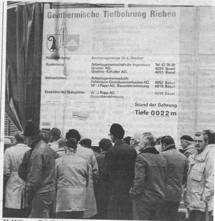
22 Millionen Franken kostet die letzte Bauetappe für die Geothermierung (im Bild die Bohrstelle Bachtelenweg) und für das Wärmeverteilsnetz. Im Januar 1994 soll der Wärmeverbund mit Thermalwasser seinen Betrieb aufnehmen. Archivbild
