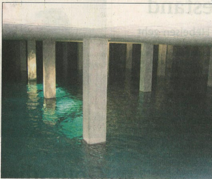
Ein Trinkwasserreservoir in Basel.
