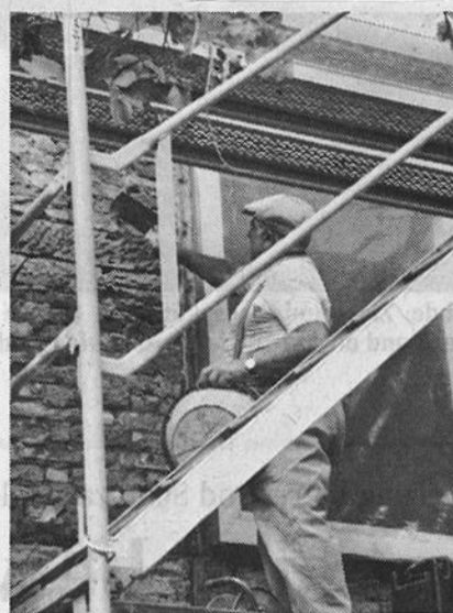
Das Kratzen an der Oberfläche des Verputzes brachte die neuen Erkenntnisse ans Licht. Foto: Judith Fischer
